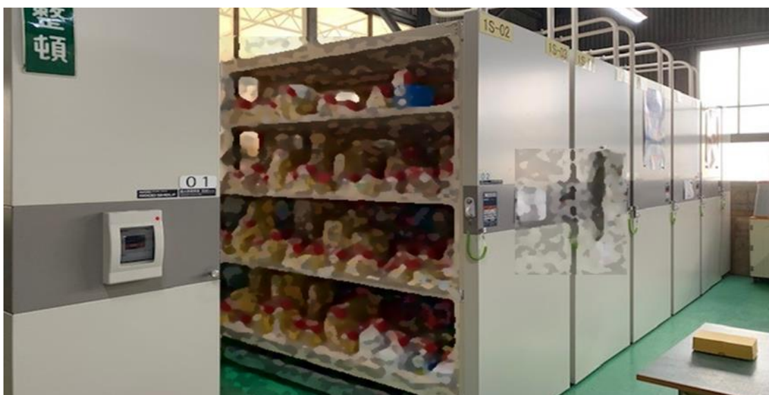
図7-多品種少量出荷商品の保管用自動ラック
